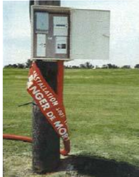
Branchement provisoire sur terrain nu ⇒ non fixe
