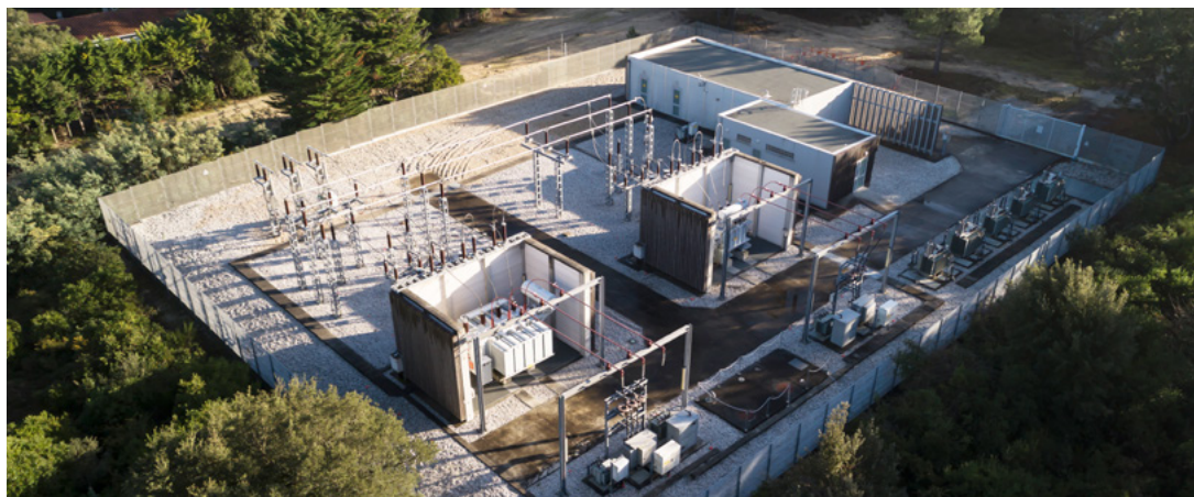
Figure 3 : un poste source [63 kV à 20 kV] au cap Ferret
