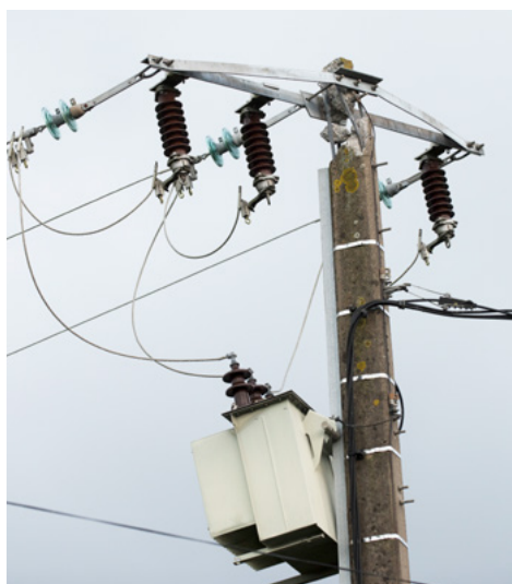
Figure 4 : poste de distribution publique aérien. Réseau HTA à gauche, transformateur HTA/BT sur poteau, réseau torsadé BT à droite
